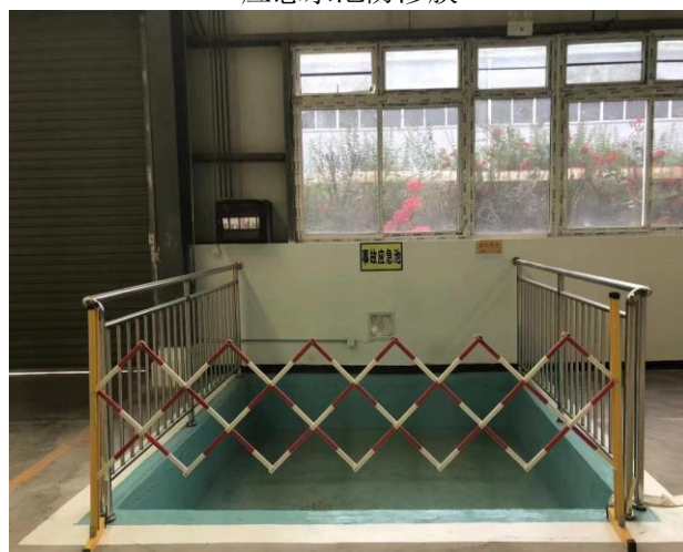
拆解车间应急水池
