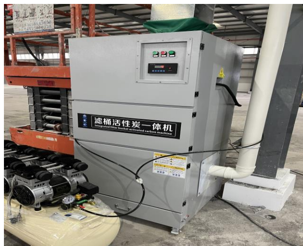
布袋除尘器+活性炭一体化设施
